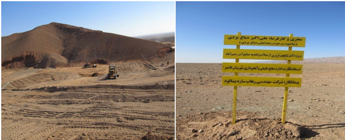
شکل ۱ - تصاویر منطقه و بند خاکی روستای رحیم آباد شهرستان کاشمر استان خراسان رضوی
